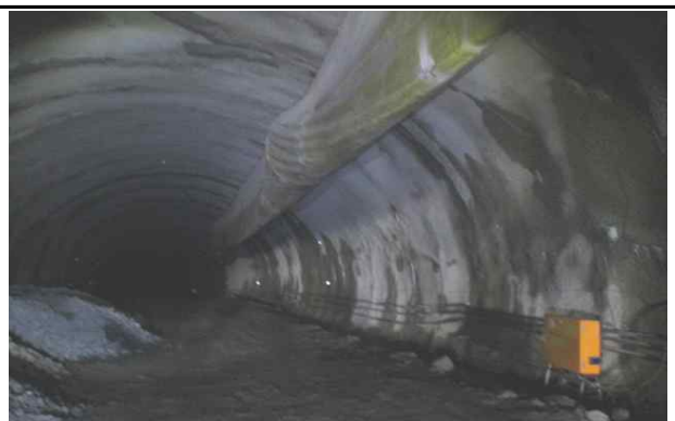
내부 환기시설 현황
