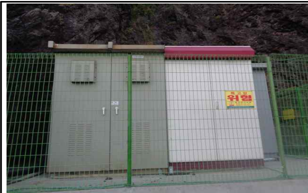
외부 전기시설 전경
